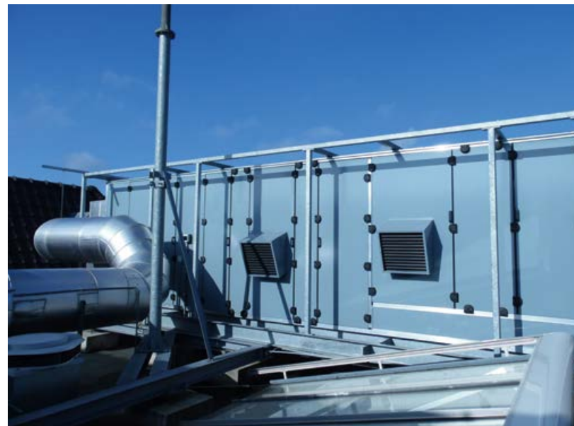
Luchtbehandelingskast op het dak van Greenchoice.
