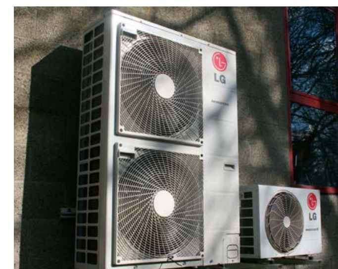
LG Inverter et LG Inverter V à l'arrière du bâtiment.
