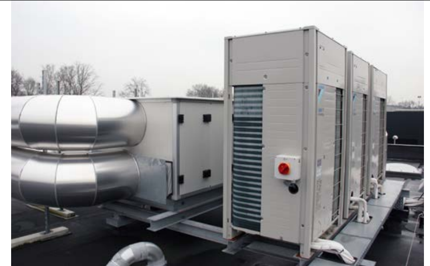
Le siège de Cibur est équipé de trois appareils, de 10, 12 et 16 CV.
