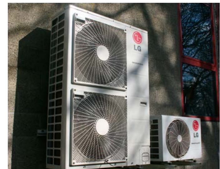
De LG Inverter en de LG Inverter V aan de achterzijde van het gebouw.
