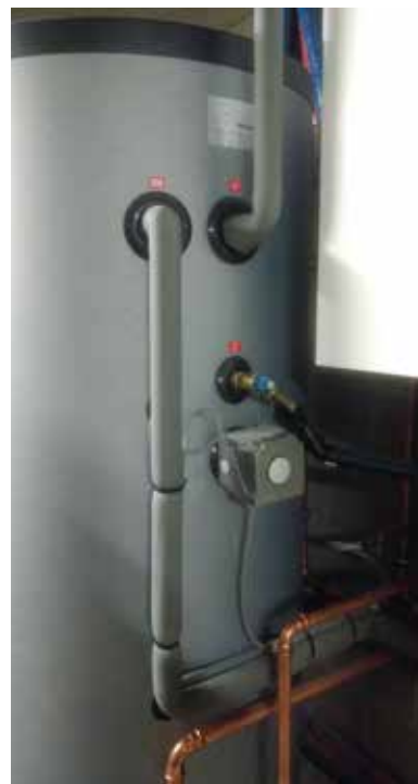
Un chauffe-eau de 300 litres a été prévu.
