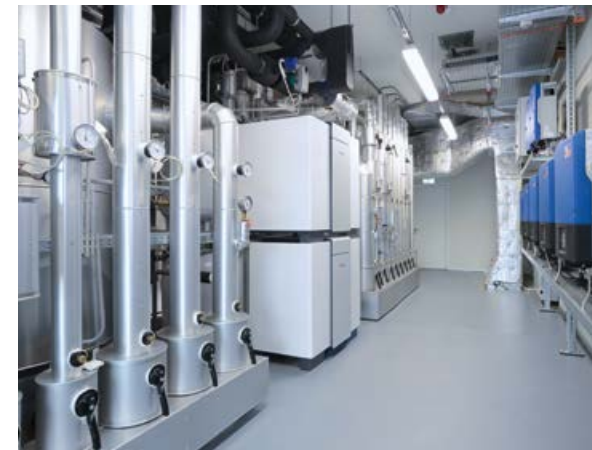
De Energy Campus wordt verwarmd door een cascade van twee water-waterwarmtepompen. De stookplaats maakt mee deel uit van het lesconcept.
