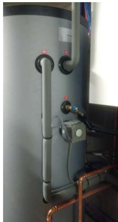
Er is een boiler van 300 liter voorzien.
